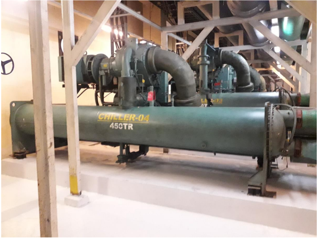
Gambar Mesin Chiller
